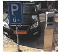
Elektrische laadpaal let op aansluitkabel / leiding
