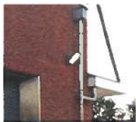
Verlichting aan het pand
