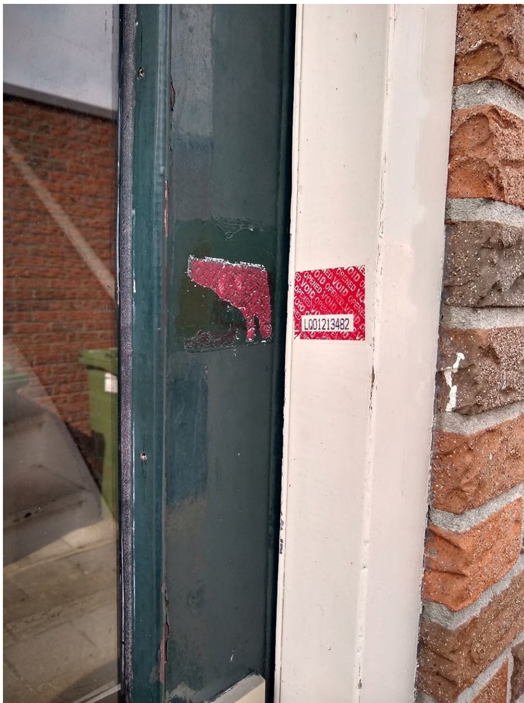
Foto 1 toegangsdeur met een verbroken zegel LQ01213482
