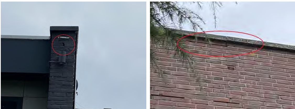
Foto 10 en 11. Voorbeelden van aangetroffen holtes en ruimtes onder de daktrim.
